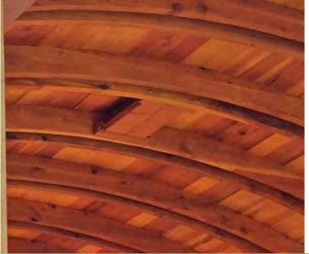
Ceiling Fan Base
